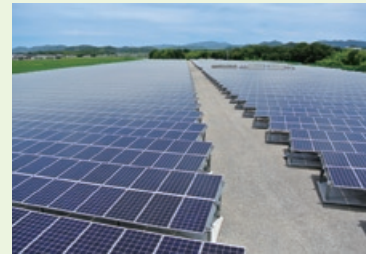
(美樹工業加西メガソーラー発電所 全景)
